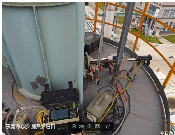
图 7.1-2 加热炉废气进口
