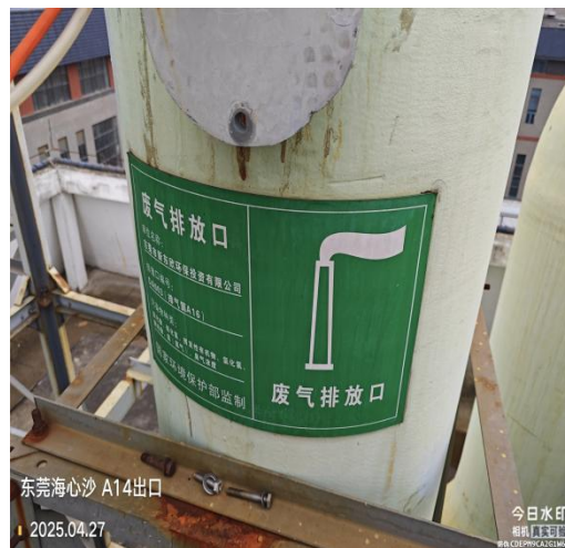
A14 废气排放口标识牌
